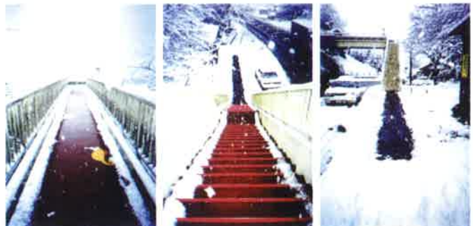
ヒーター運転状況
