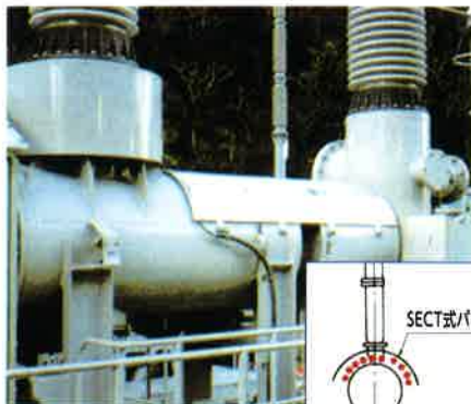
GIS(ガス絶縁開閉装置)融雪ヒーター
