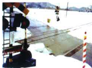
ヒーター運転状況
